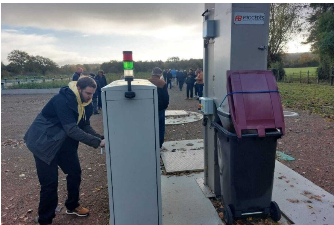
Les eaux usées arrivent à la station par un poste de relèvement, qui opère un pré-traitement. ©LOrne hebdo
